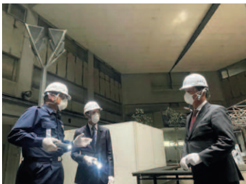
白岡市役所火災の現場を視察。深刻な被害状況を目の当たりにして、復旧には国の支援が必要と強く認識。後日、古川俊治参院議員とともに総務省に説明に赴く
